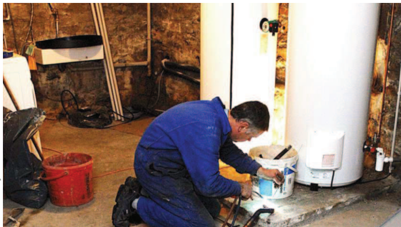
Les systèmes comme les pompes à chaleur (électriques) tendent à se développer.
